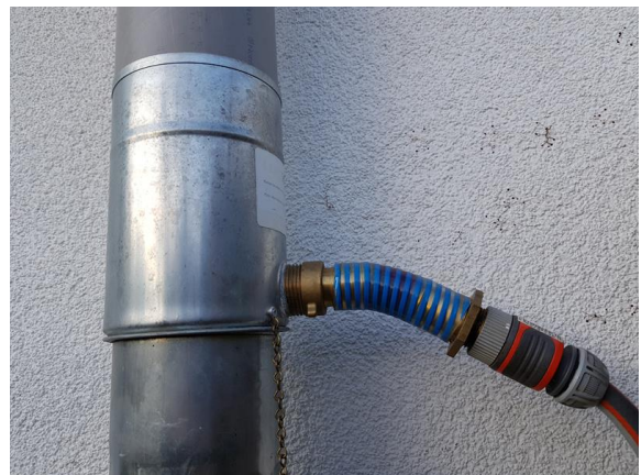
Der „Regendieb“ im Fallrohr. Eine einfache Möglichkeit Wasser abzuzweigen - für die Regentonne oder zur direkten Bewässerung und Versickerung.
