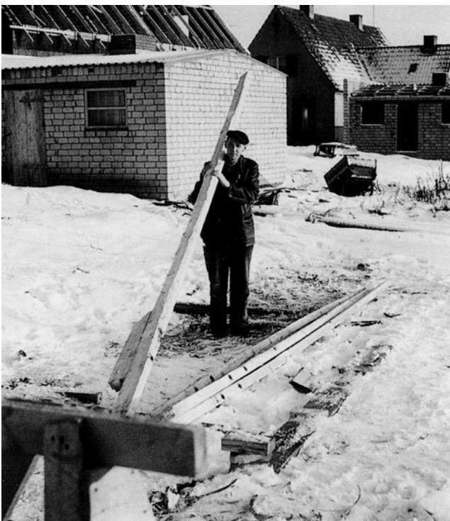
Eigenhilfe baut auf... 1965: Karl-Heinz Mehrens bereitet Arbeiten am Dachstuhl des Hauses in der Franz-Wieman-Straße vor. (Bild von S.155)
