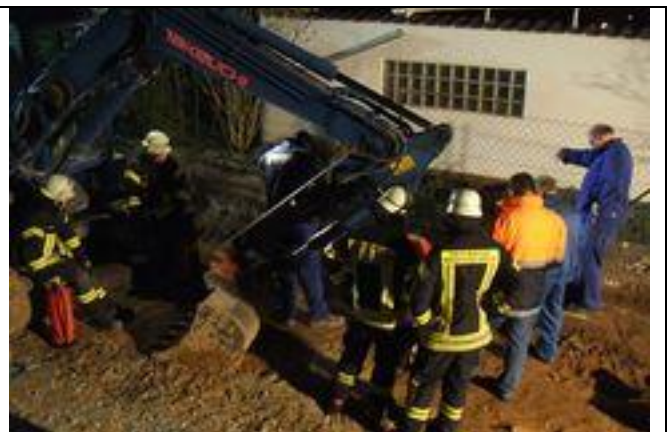
Nächtlicher Gasalarm Baustelle Am Mühlrain
