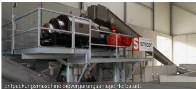
Entpackungsmaschine Biovergärungsanlage Herbstadt
