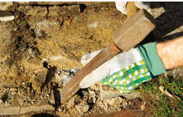
Gefährlich ist es erst, wenn Asbestfasern durch Bearbeitung freigesetzt und eingeatmet werden.
