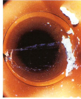
Schadensbild „Eindringendes Grundwasser“
