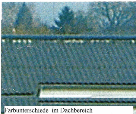
Farbunterschiede im Dachbereich
