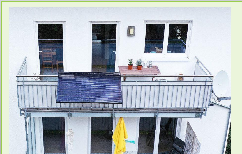
Abb. 5: Balkonsolaranlage Quelle: badenova
